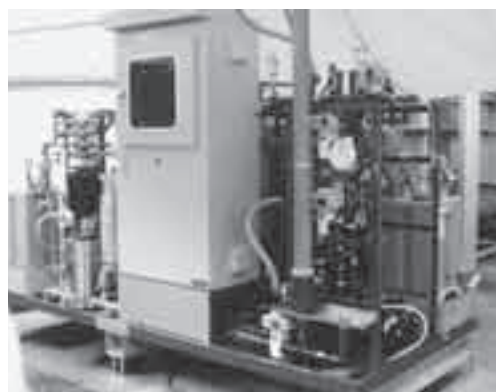
逆浸透膜・汚水処理機
