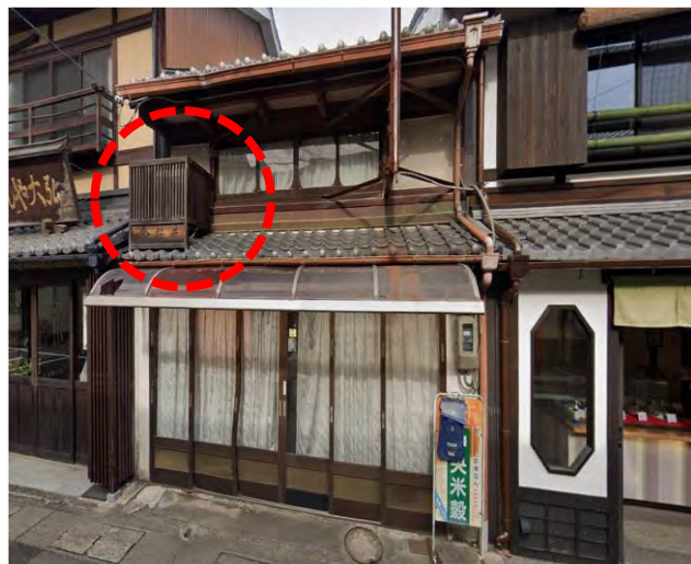
空調設備をルーバーで覆った例
