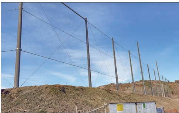
工事請負変更契約の締結が議会で可決する前に着工された変更内容の工事に含まれる防球ネット
