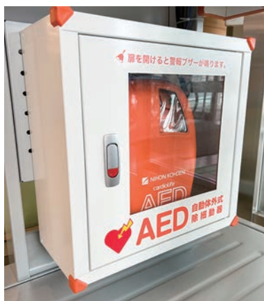
屋内に設置されているAED
