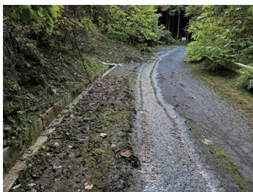
土砂で埋まった側溝
