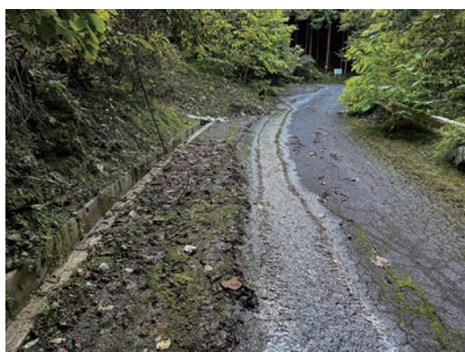
土砂で埋まった側溝
