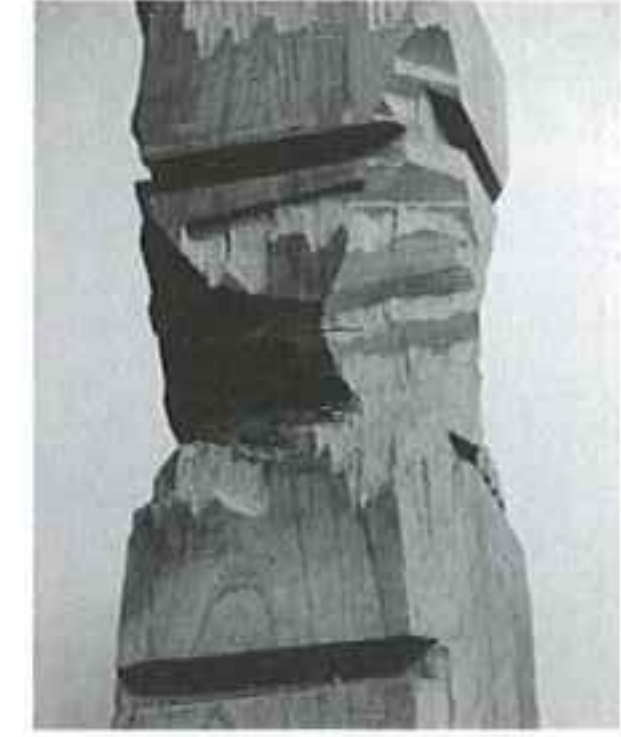
24 商家の柱の傷跡
