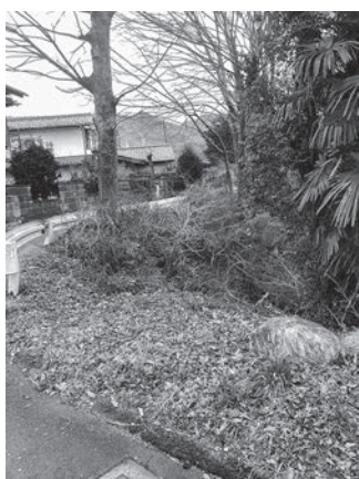
危険が指摘されている崖沿いの道
