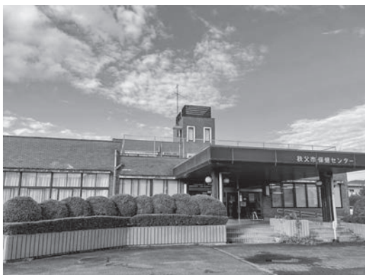
老朽化の著しい保健センター
