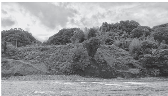
水辺再生100プランで整備された荒川の対岸、大きく河川敷へとせり出している土砂たい積
