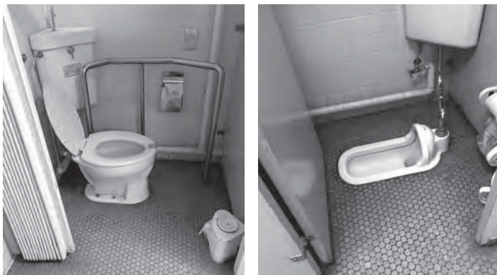
改修の要望があるトイレ
