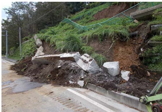
国道299号側面の土砂崩落
