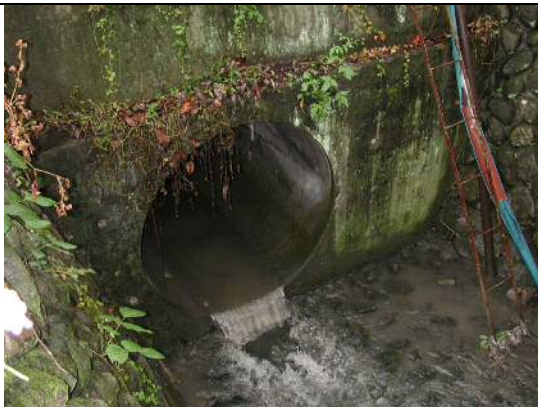
未処理下水の放流状況（市内）
