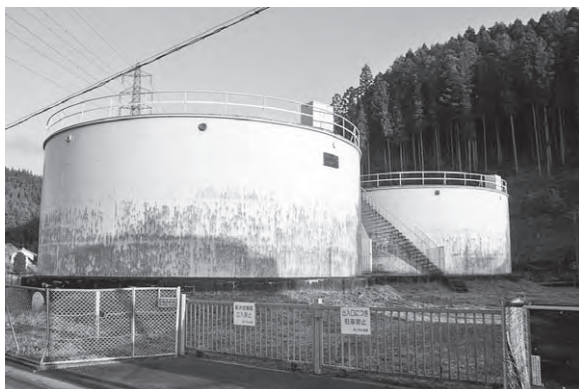
腐食が進む影森旭町上水道貯蔵タンク
