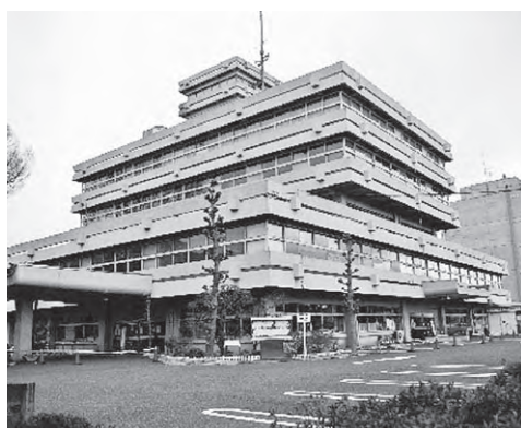
被災度判定で「大破」と診断された本庁舎
