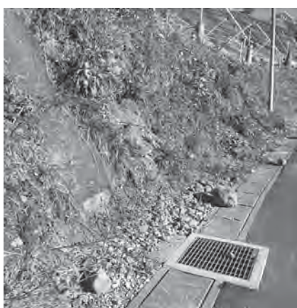
台風後に太陽光発電設備周辺で見られた市道への落石
